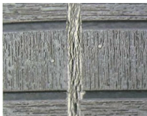
シーリング材の破断
