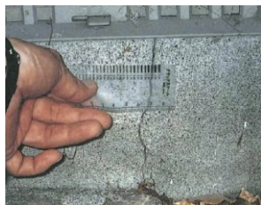
基礎のひび割れ
