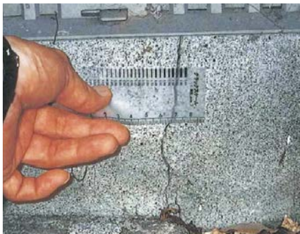
基礎のひび割れ
