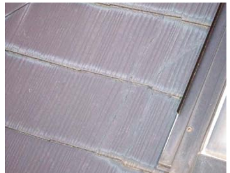
屋根葺き材のひび割れ
